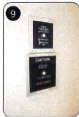
Corridor med gas panel
