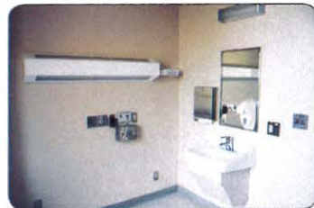
Handwash sink, lighting, med gas system
