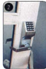
Terrace door keypad
